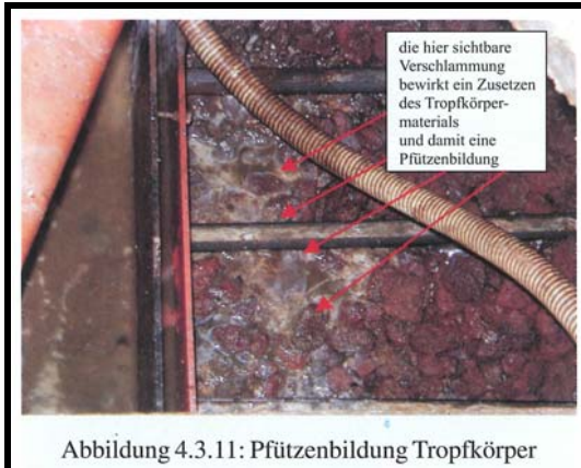
Abbildung 5: Pfützenbildung bei einer Tropfkörperanlage
